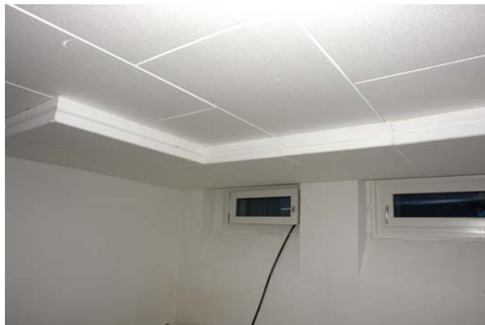
Abbildung 54 Dämmung der Kellerdecke von unten mit Nut-und-Feder-Platten aus EPS. Auch unter den Stürzen der Kellerfenster sollte gedämmt werden. (Quelle: Architekt Schulze Darup, Sanierungsprojekt Jean-Paul-Platz, WBG Nürnberg )
