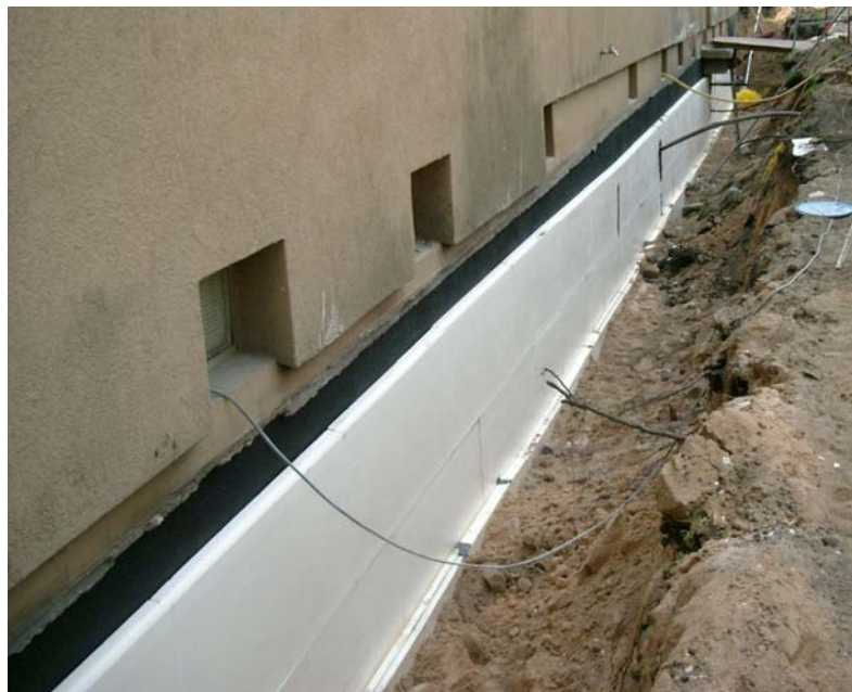
Abbildung 57 Muss die Kellerwand ohnehin für das Aufbringen einer Feuchtigkeitssperre aufgegraben werden, so ist die gleichzeitige Anbringung einer Wärmedämmung im Erdreich sinnvoll. (Quelle: Architekt Schulze Darup, Sanierungsprojekt Ingolstädter-Str., WGB Nürnberg)
