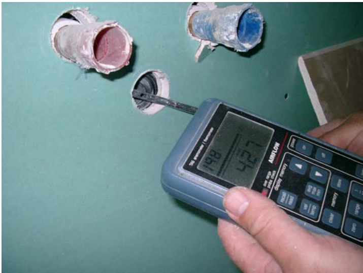
Abbildung 113 Nach der Fertigstellung der Verkleidung von Vorwand-Installationen ist die Behebung von beim Drucktest gefundenen Leckagen in der dahinter liegenden luftdichten Ebene (Wandputz) nicht mehr zerstörungsfrei möglich. (Quelle: Architekt Schulze Darup, Sanierungsprojekt Ingolstädterstr., WBG Nürnberg)
