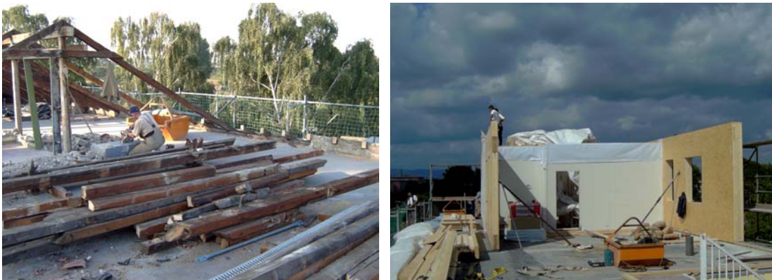
Abbildung 71 Abriss des alten Dachstuhls und anschließende Aufstockung in Passivhausqualität mit vorgefertigten Holzelementen (Quelle: faktor10 Darmstadt)
