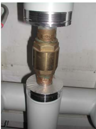
Abbildung 144 Stirnscheibe am Rohr, Rückschlagventil nicht gedämmt (Foto: inPlan Ingenieurbüro)
