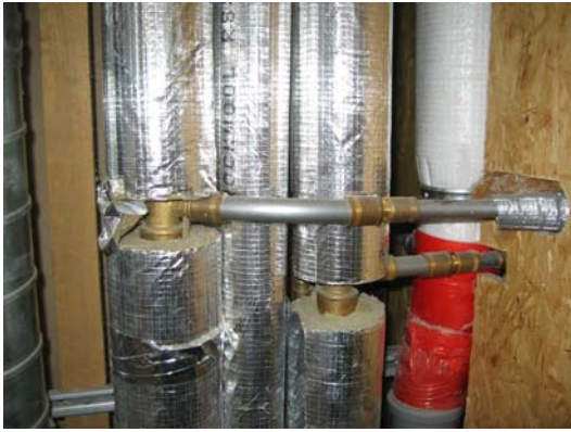
Abbildung 143 fehlende Leitungsdämmung / unterbrochen / Stichleitung zu schwach gedämmt (Foto: inPlan Ingenieurbüro)
