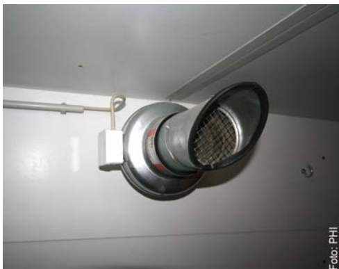
Abbildung 55 Abluftventilator für die Kellerentfeuchtung (Quelle: PHI [203])
