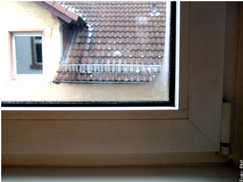
Abbildung 96 Sichtbarer Ausdruck der Wärmebrückenwirkung von Aluminiumabstandhaltern ist die Bildung von Kondensat aufgrund niedrigerer Innenoberflächentemperaturen am Rand der Verglasung. (Quelle: PHI)
