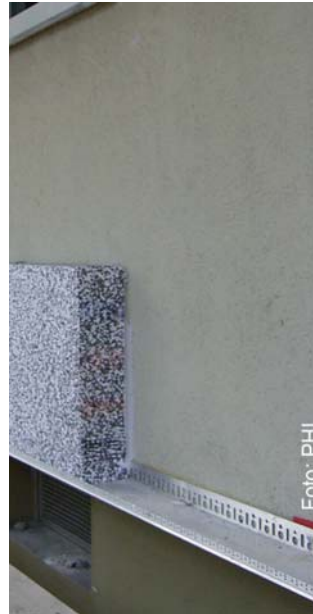
Abbildung 15 Konventionelle Sockelprofile aus Aluminium verursachen starke Wärmebrücken-Effekte (Quelle: PHI)
