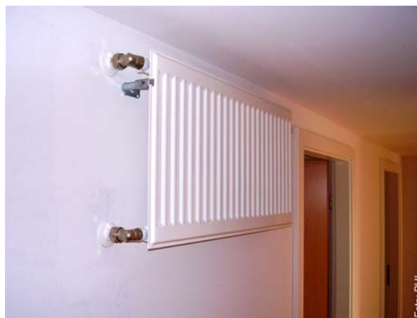
Abbildung 118 Kleiner Heizkörper zur Deckung der zusätzlichen Heizlast für die Erdgeschosswohnung eines modernisierten Altbaus. (Quelle: PHI, [203])
