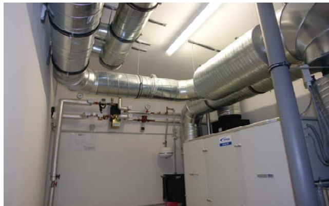
Abbildung 129 Lüftungszentrale für ein Mehrfamilienhaus (Quelle: Architekt Schulze Darup, Sanierungsprojekt Bernadottestr., WBG Nürnberg)
