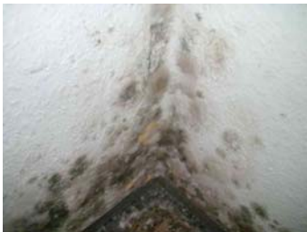
Schimmelbildung an einer Außenecke im Sockelbereich aufgrund zu geringer Oberflächentemperaturen (Schulze Darup)
