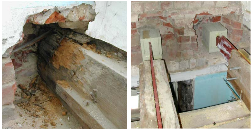
Abbildung 52 Durch Feuchtigkeit zerstörter Balkenkopf im Bestand (links) und sanierter Zustand vor Aufbringung der Innendämmung (rechts). Der zerstörte Balkenkopf wurde abgesägt und der Deckenbalken im gesunden Holz mittig geschlitzt. Im Schlitz wurde ein Stahlschwert mit Stabdübeln befestigt. Das Auflager des Stahlschwerts im Mauerwerk wurde zur Verminderung der Wärmebrückenwirkung mit PU-Recycling-Dämmstoff „eingepackt“. (Quelle: Projekt Ensan, 'Kleine Freiheit' in HH-St.Pauli, Arch. und Foto: Dittert und Reumschüssel).
