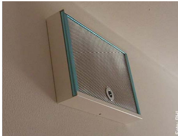
Abbildung 124 Metallisches Fettfilter vor einem Ablufteinlass in der Küche (die Abdeckblende wurde für das Foto entfernt) (Quelle: PHI, [203])
