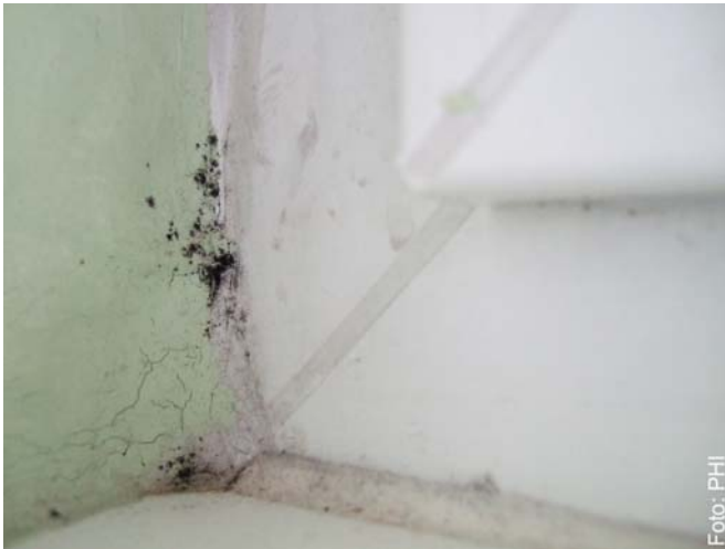
Abbildung 90 Schimmel am Fensteranschluss nach dem Einbau dichter Fenster in einem Altbau ohne gleichzeitige Verbesserung des Wärmeschutzes der Fassade (Quelle: PHI)
