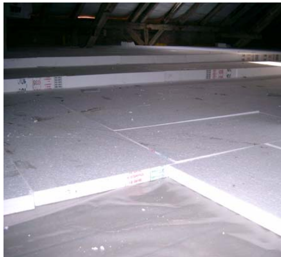
Abbildung 69 Mehrschichtige Dämmung der obersten Geschossdecke mit EPS. Vorne im Bild die Dampfbremse zwischen dem alten Dielenbelag und der Dämmung. (Quelle: Architekt Schulze Darup, Sanierungsprojekt Jean-Paul-Platz, WBG Nürnberg)
