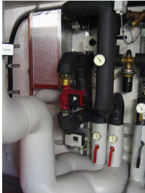
Abbildung 142 Fernwärmestation und verstärkte Leitungsdämmung der abgehenden Leitungen (Foto: inPlan Ingenieurbüro)
