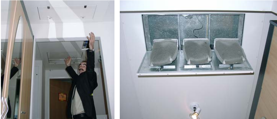
Abbildung 130 In die abgehängte Decke integriertes Lüftungsgerät mit Revisionsöffnungen für das Zentralgerät und die Taschen-Luftfilter(Quelle: [99])
