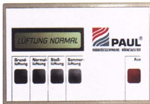
Abbildung 33: Bedienteil der Lüftungsanlage im Windfang der Passivhäuser (mit Klartext Display)
