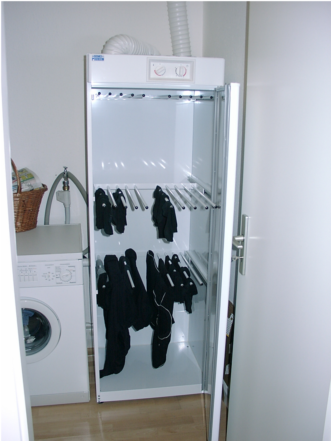
Abbildung 40: Trockenschrank in einem der Passivhäuser; der Fortluftschlauch ist an den Abluftstrang der Lüftungsanlage angeschlossen.
