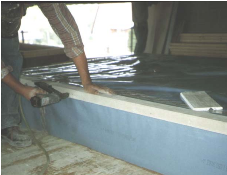
Abbildung 55: Die Folie wird mit Hilfe des Eckabschlußelementes angeheftet; damit ist der luftdichte Einbau vorbereitet.
