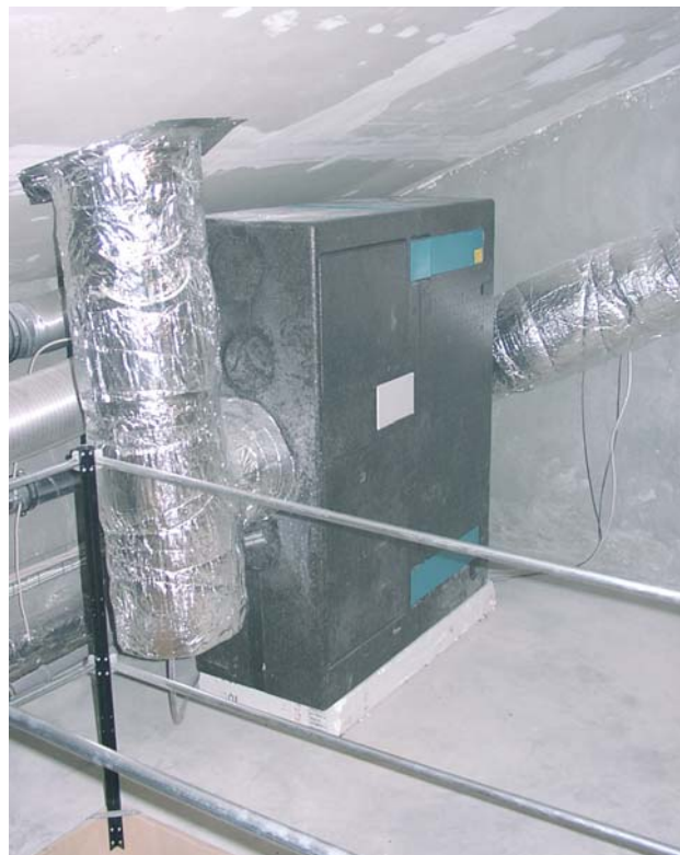
Abbildung 32: Lüftungsgerät mit Wärmerückgewinnung im Technikgeschoß eines Passivhauses in Hannover-Kronsberg. Im Hintergrund das Frischluftrohr mit Defrosterheizung und im Vordergrund das Fortluftrohr (beide mineralwolle gedämmt mit Alukaschierung)
