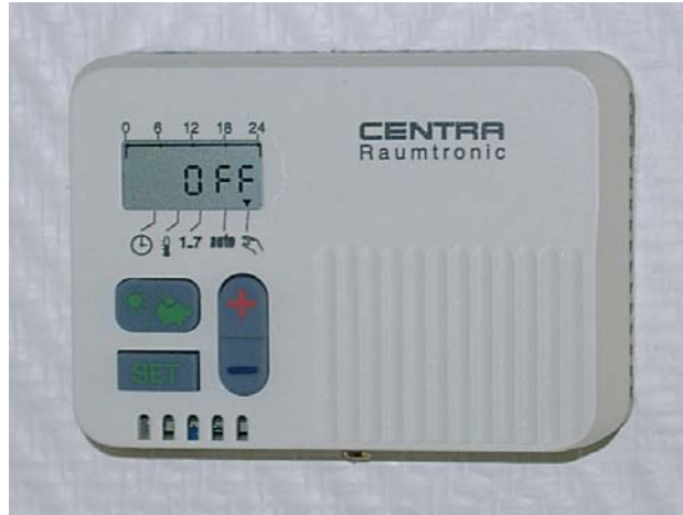
Abbildung 38: Raumthermostat mit Zeitschaltuhr im Flur EG (in „off“-Stellung)
