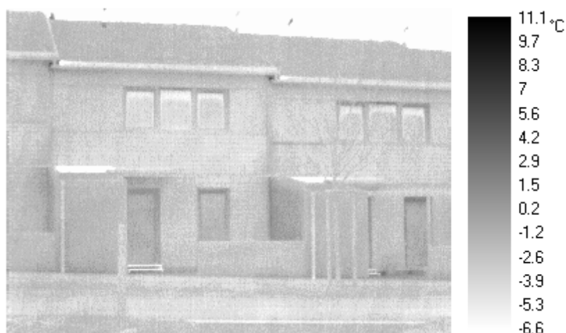
Abbildung 66: Außenthermographie eines Ausschnitts der Häuser von Reihe 9 (Nordseite). Der Bereich unter dem Dachüberstand und unter dem Vordach über der Haustür erscheint wärmer, da diese Bereiche gegenüber der nächtlich kalten Himmelsstrahlung „abgeschattet“ sind. Die Fassaden zeigen ansonsten durchgehend niedrige Temperaturen von etwa -4\text{ °C} .
