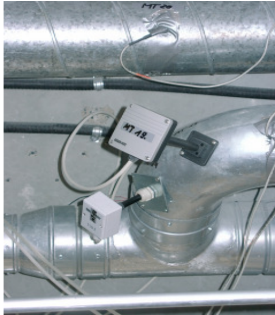
Abb. 18: Kanaltemperatur- und Kanalfeuchtesensoren im intensivgemessenen Haus.
