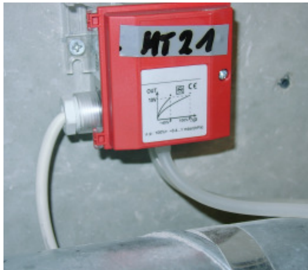
Abb. 20: Differenzdruckmeßdose für die Fortluftmessung (Volumenstrombestimmung) Die Druckschläuche führen zum Meßkreuz im Fortluftrohr.
