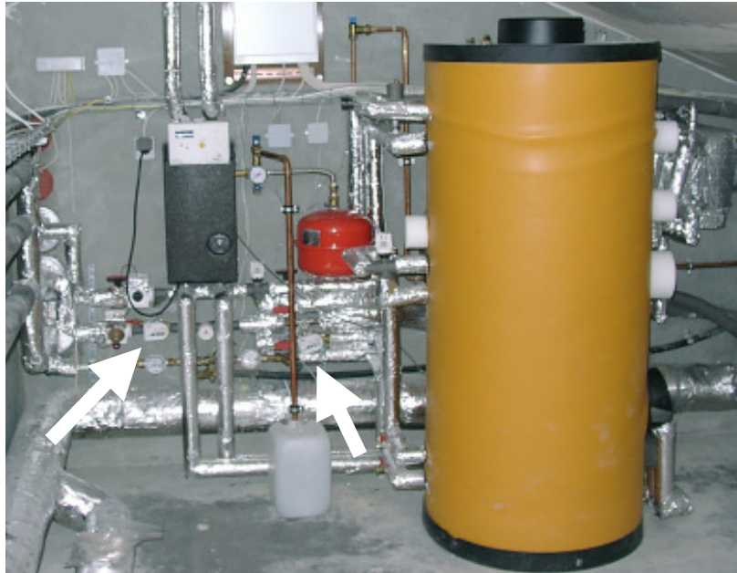
Abb. 9: Installationswand im Technikgeschoß mit Brauchwasserspeicher. Die beiden Wärmemengenzähler sind mit Pfeilen markiert.
