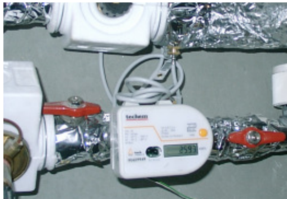
Abb. 10: Gesamt-Wärmemengenzähler an der Installationswand im Technikgeschoß. Das Kabel führt zum Temperaturfühler (Pt 500) in der Vorlaufleitung.
