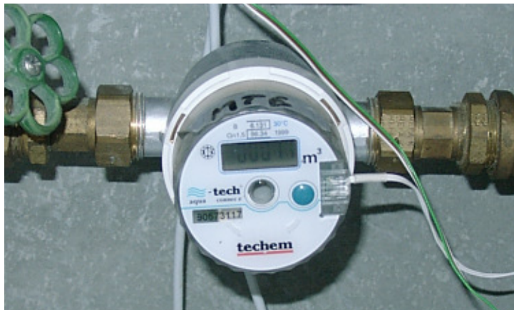
Abb. 12: Hauptwasserzähler im Technikgeschoß.
