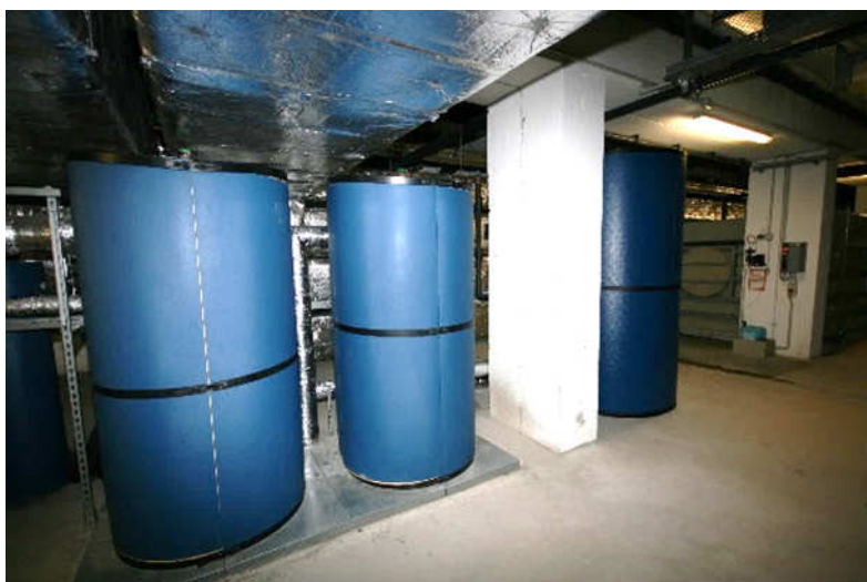
Abbildung 89: Drei wärmeisolierte Warmwasserspeicher im Technikeller des Bambados
