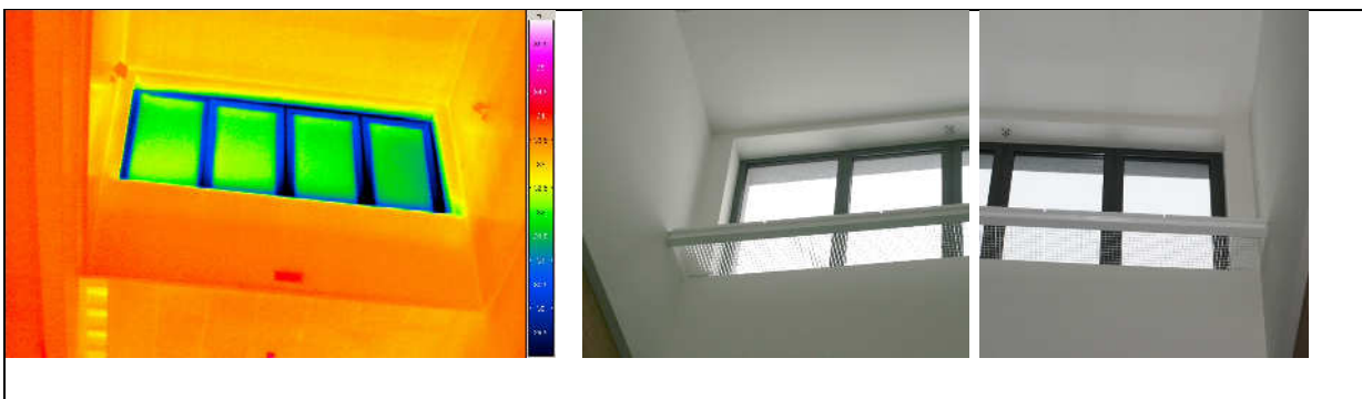
Abbildung 43: Blick in ein Dach-Shed mit Verglasung. Das Lichtbild zeigt den Dachaufbau (Shed) mit einem Gitterrost zur Wartung; das Thermogramm ein anderes Shed ohne Gitterroste.
